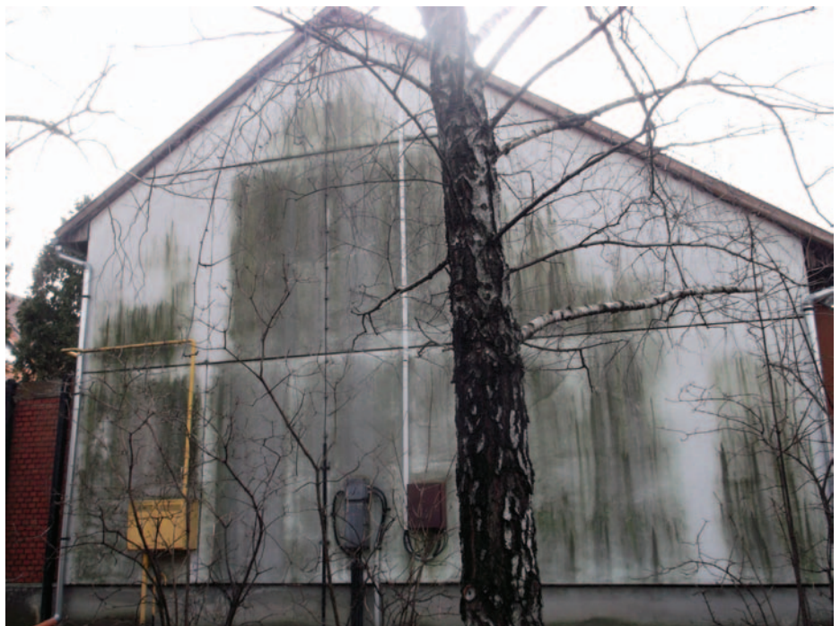
3–4. kép. „Fekete” alga, hagyományos kőporos vakolaton, „zöld” alga” festett panelfalon Egyiken sincs hőszigetelés. Az elsőn jól látható téglafalás és vasbeton koszorús alap vakolatán a viselkedéskülönbség, de épp így az oromszegély és a szárnyfal lefedése által védett sáv más helyzete.
