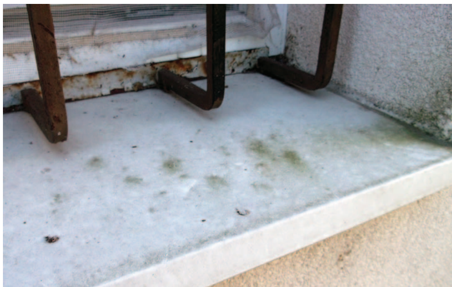
1–2. kép. Azonos épülethomlokzaton két fémlemez borítású ablakpárkány, egymás melletti két szomszédos lakáson. Az első jól karbantartott, a második „elhagyott” (amit az acélrács korróziója is jelez).
