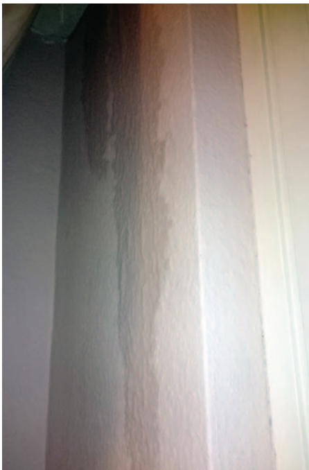
3. kép. Víz csorog a mennyezetről
