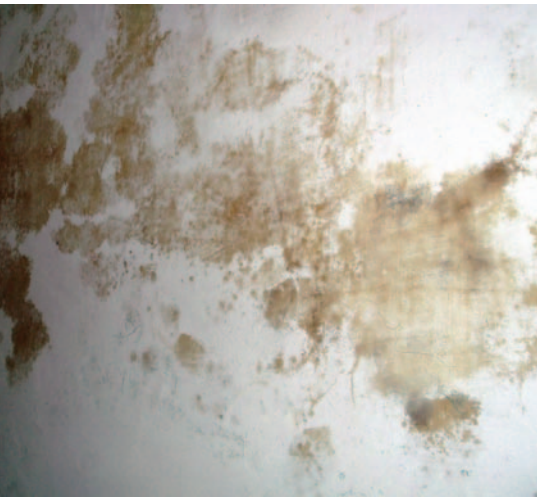
2. kép. Előrehaladott beázásos vakolatromlás, körülbelül a fal közepén
